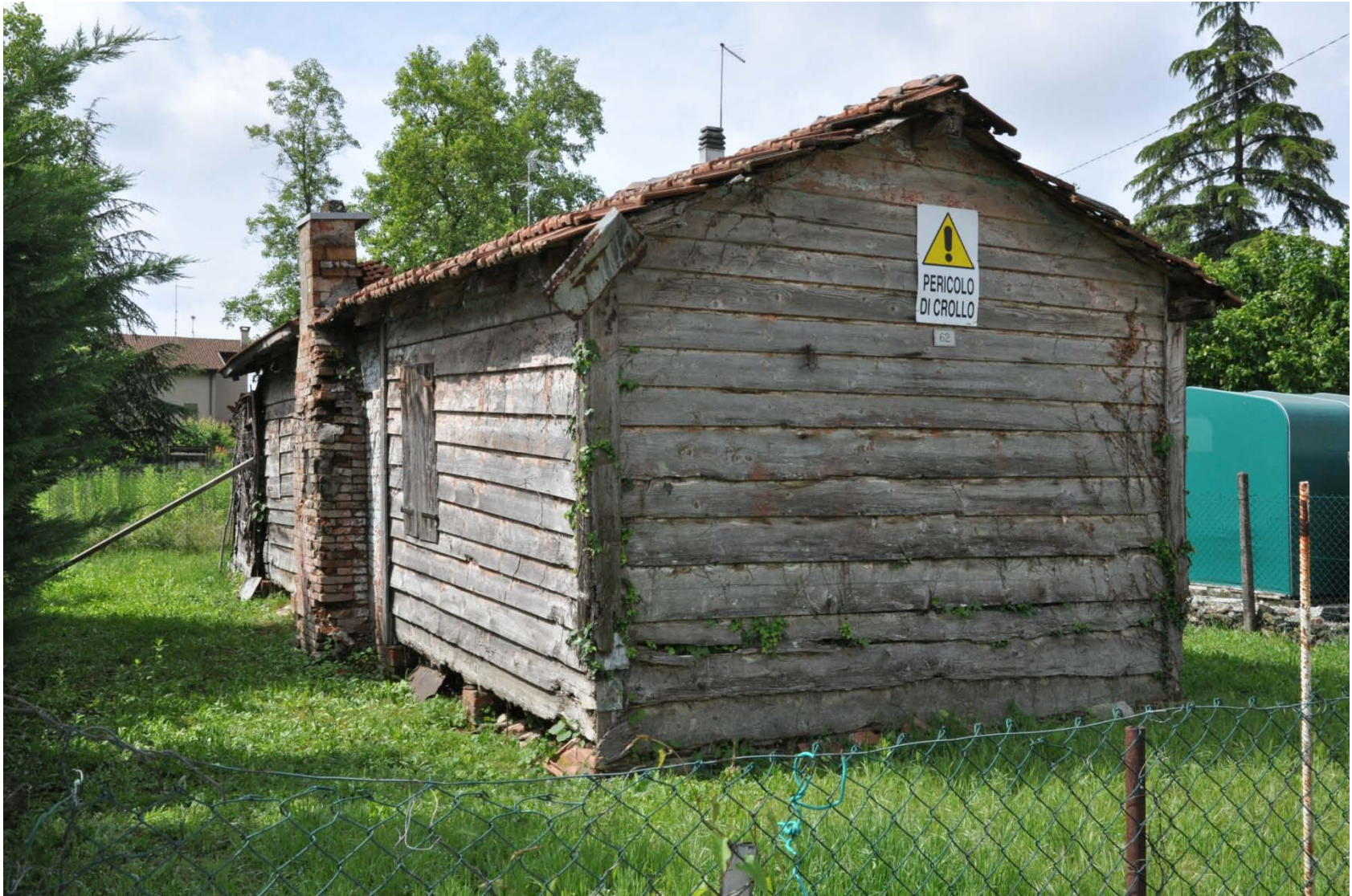
Archivio Fotografico club 54 San Donà di Piave baracca in legno con il fogher in muratura ancora visibile ancor'oggi in via Dalla Francesca
