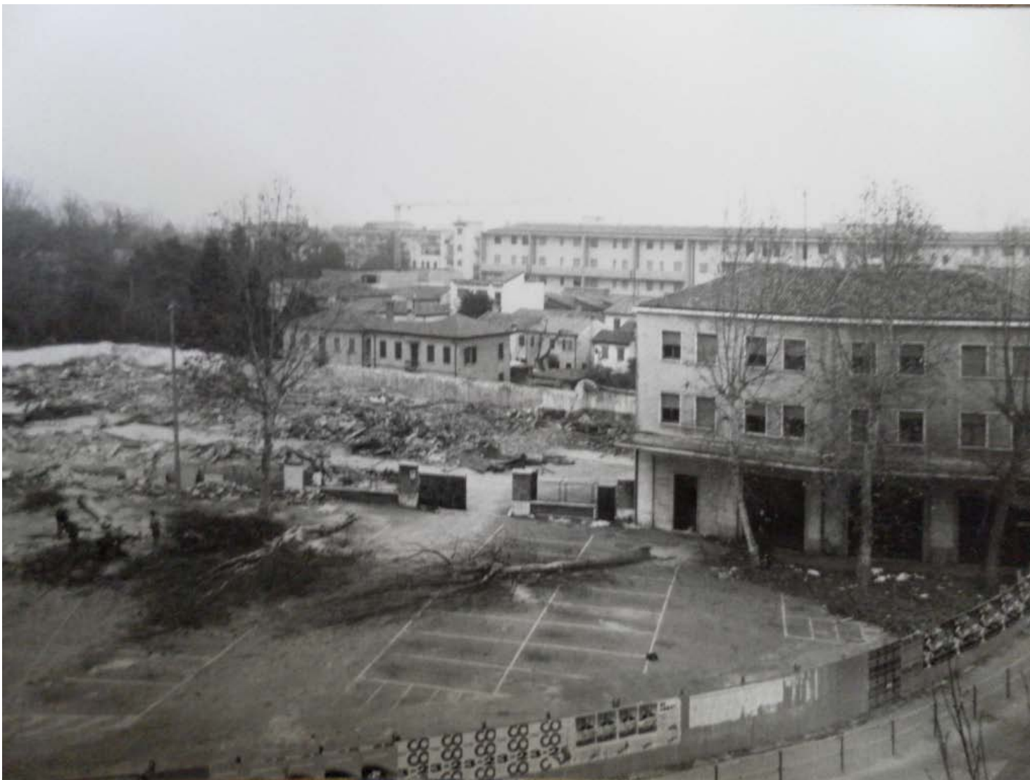
Archivio fotografico club 54 il lato sinistro del Consorzio Agrario già demolito foto A: Mestre anno 1992
