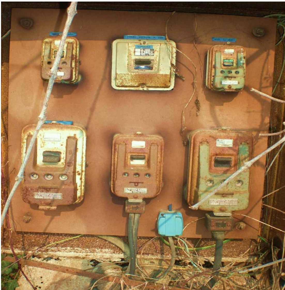
Archivio fotografico club 54 particolare di quel che rimane del quadro elettrico della gru
